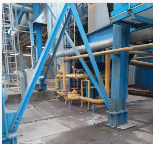
Foto 2 Gasleiding voor de droogtrommels
